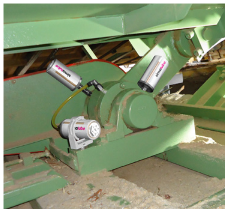
Les paliers d'une goulotte vibrante sont alimentés de façon continue par trois graisseurs.
