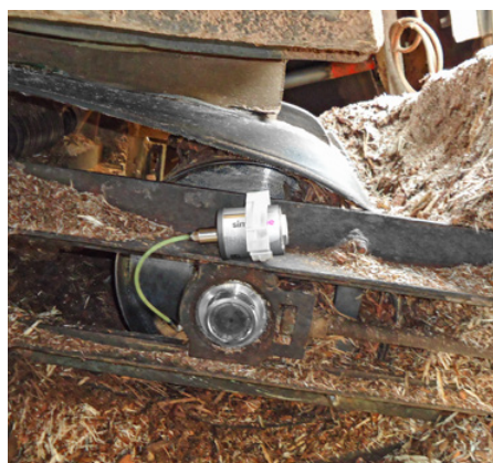
L'unité de serrage des roulements en Y d'un convoyeur est alimentée de façon continue avec de la graisse.
