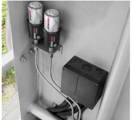
Se utilizan dos simalube IMPULSE connect debido a las líneas de lubricación instaladas permanentemente en un rascador para piscinas. Superan la contrapresión y aseguran una lubricación continua.
