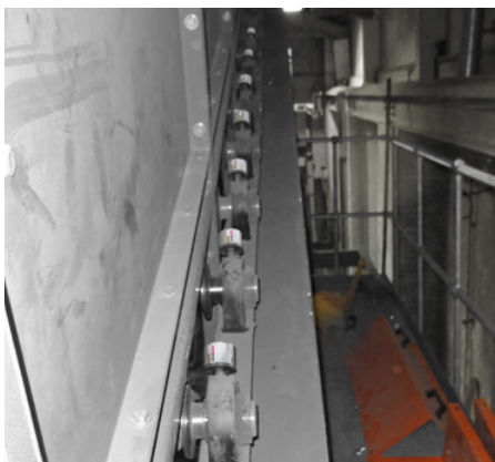
Dutzende 30ml simalube Schmierstoffspender versorgen die Wälzlager eines Förderbandes mit dem nötigen Schmierstoff.
